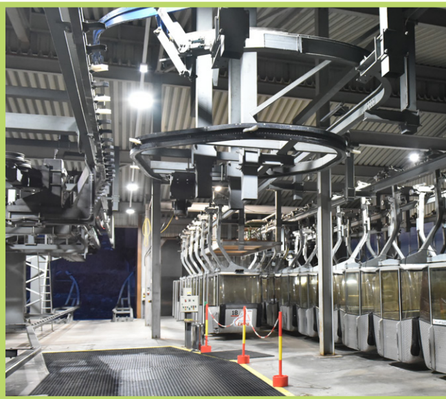
DeltaLUXX - Osvětlení stanice gondola
