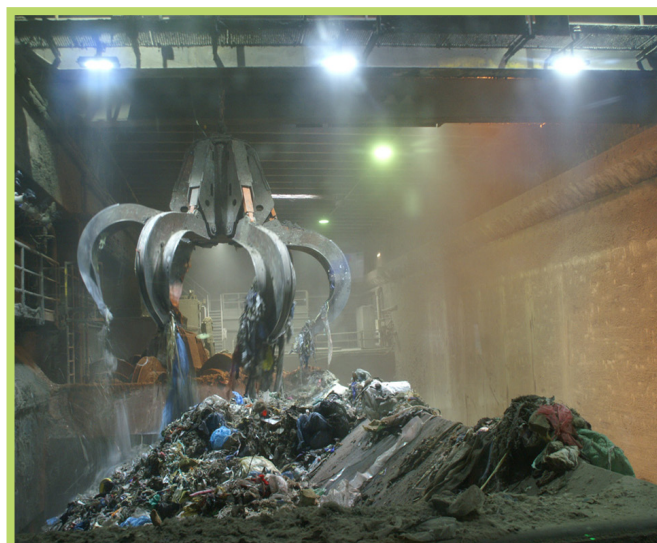
PLAZA - Osvetlenie v spaľovni odpadu
