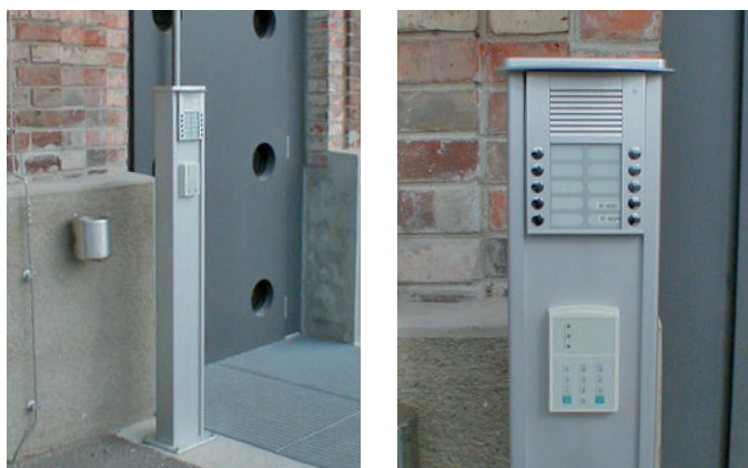
GAS 160 – Kontrola prístupu na výstavnisko Viede
