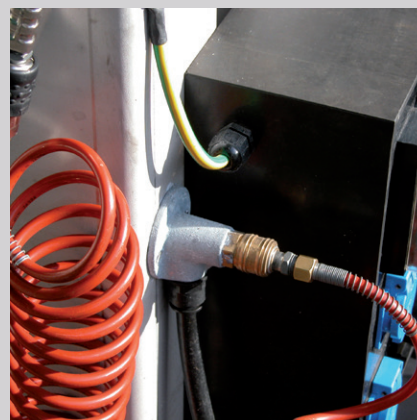
Prípojka stlačeného vzduchu na kryte šachty.
