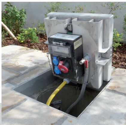
Obec Schneegattern: Podzemný rozvádzač PIAZZA 540 s dvoma káblovými výstupnými otvormi a prípojkou vody.
