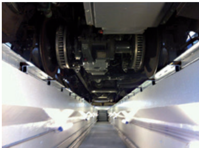
Osvetlenie montážnych jám ÖBB trakcia
