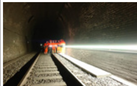
Bild: LED-Handlauf mit hoher Leuchtstärke in der Versuchsstrecke Simplontunnel
